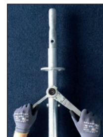
Bild 32: Åtdragning av muttrar med verktyg.
